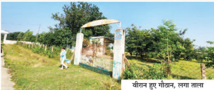
रिपा कैम्पस के कई भवन जर्जर कुछ आज तक अधूरे
